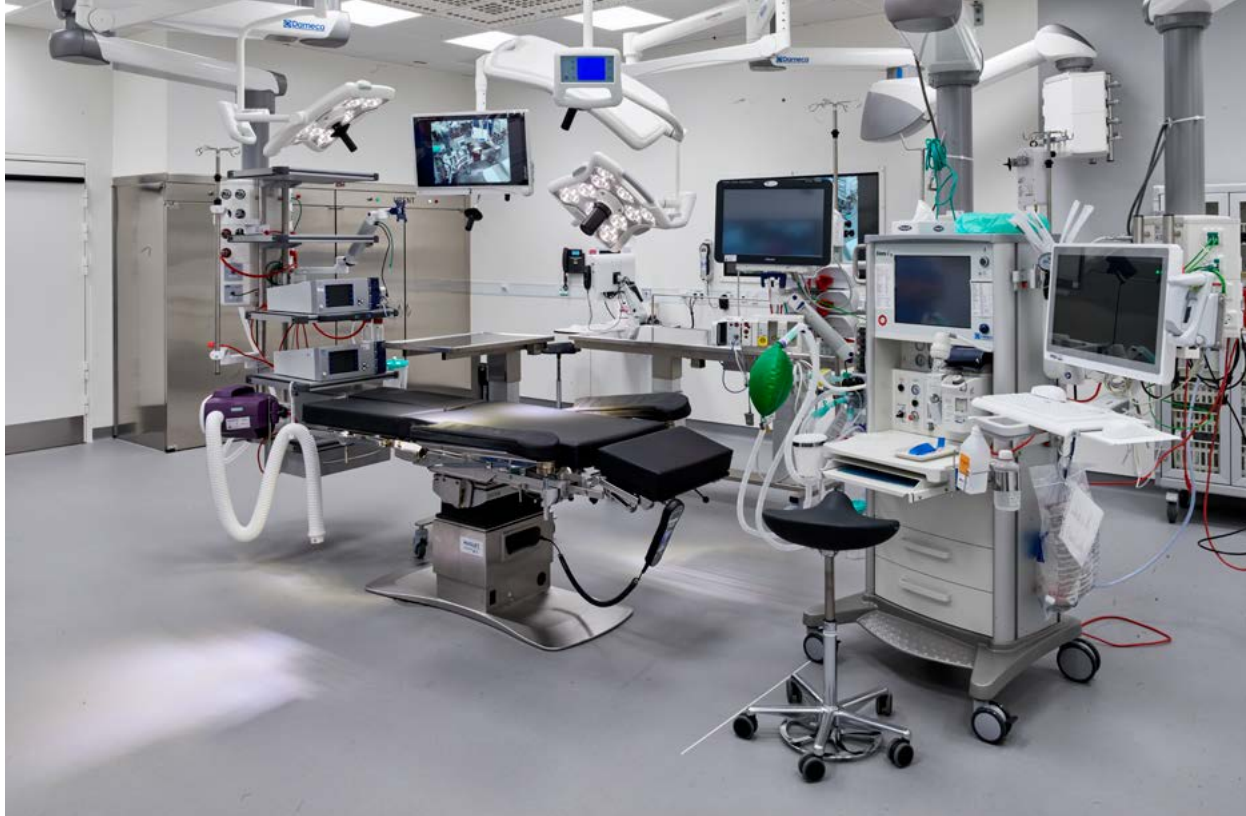
Billede 5.4.1 – På billedet ses alt det forskellige lofthængte udstyr på Fremtidens Operationsstue. Kirurgisøjlen er placeret for enden af lejet og bagved anæstesiapparatet til højre i billedet kan man se den ene anæstesisøjle, som forsyner anæstesiapparatet. Bagerst i billedets højre side, helt op imod det grå vægstykke ses forsyningssøjlen.
