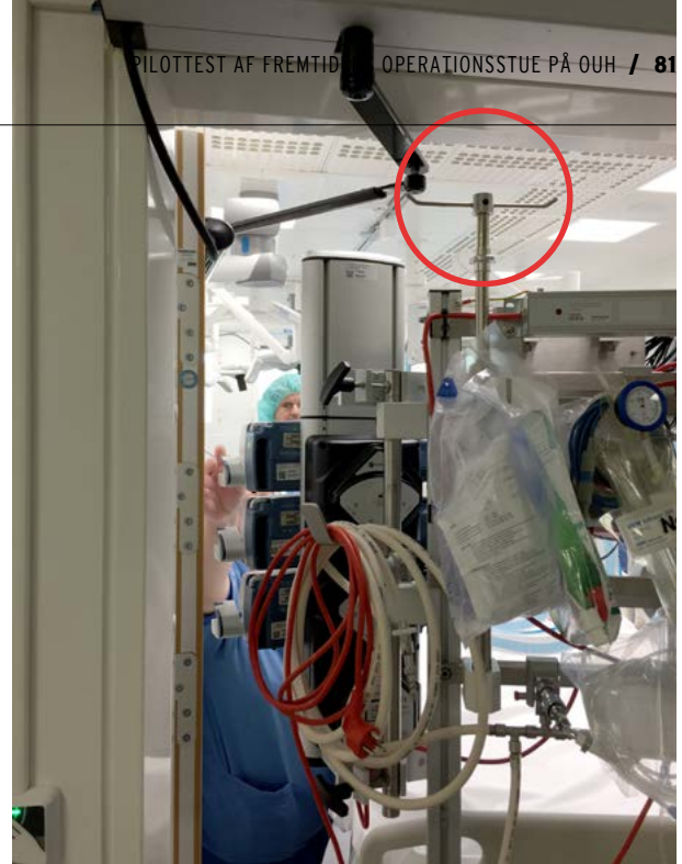
Billede 5.7.2 viser infusionspumper/-stempler, der rager ud til siden og dropstativ, der rager op og nemt støder mod automatisering/dørkam.
