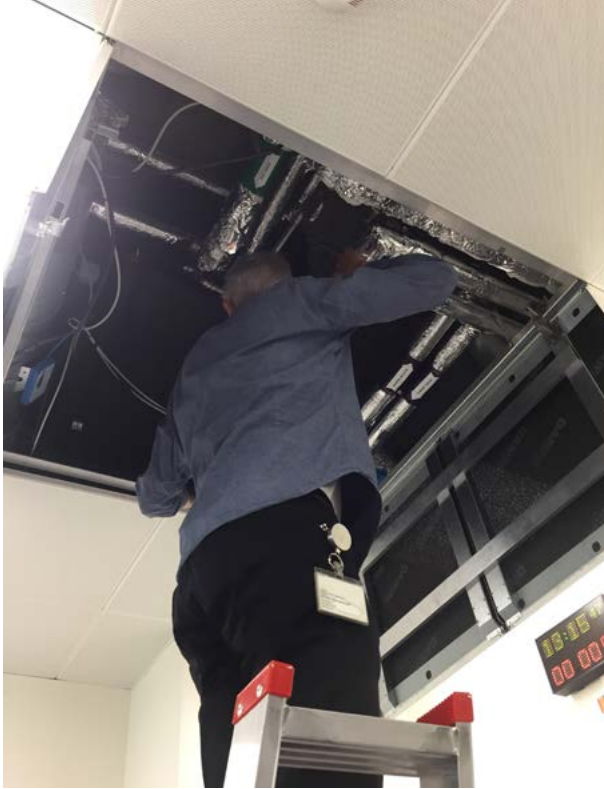
Billede 5.8.3 og 5.8.4 simuleret servicering ventila- tionsteknik og VVS fra loftslem på operationsstuen.
