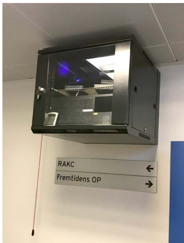
Billede 5.8.7 viser et mindre teknikskab ved RAKC centeret på OUH. Man kunne forestille sig en løsning, hvor flere bokse af denne dimensionering blev installeret i skabe over interlockskabene; én til krydsfelt, én til lysstyring og én til medicoteknisk styring. Boksene skulle installeres i skabet på et skinnesystem, så de kan hives ud af skabet og hermed muliggøre service fra flere sider.
