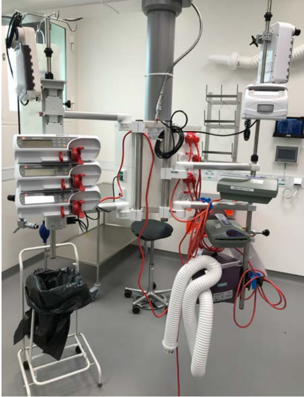
Billede 5.4.8 – På billedet ses den ene anæstesisøjle. Med de forskellige arme til pumper og andet udstyr optager søjlen meget plads.
