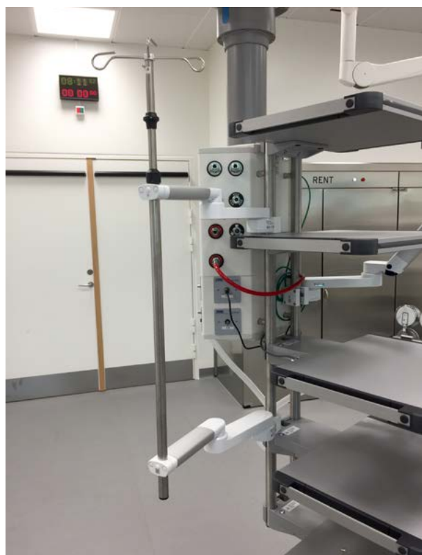
Billede 5.4.6 – Billede af dropstativ med forlænget arm på kirurgisøjlen på Fremtidens Operationsstue
