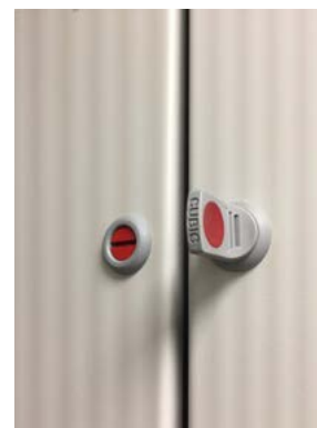
Billede 5.8.11 – Eksisterende lukkemekanisme til el-tavlerne.
