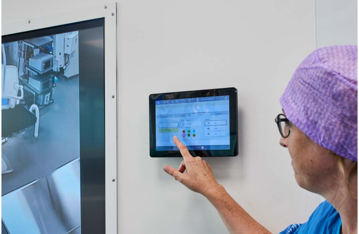
Billede 6.3.1 – På billedet ses touchpanelet på Fremtidens Operationsstue, hvorfra lys, lyd, persienner m.m. styres fra.
