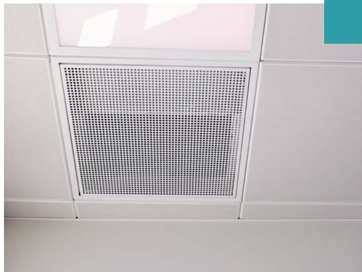
Billede 6.1.5 viser luftudsugningskanal i loftet.
